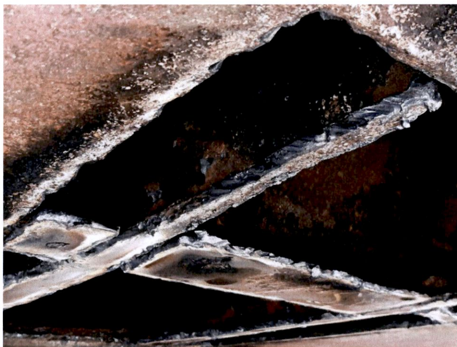
21. in evidenza corrosione diffusa e passante di madieri e paramezzale sinistro - locale bar lato sinistro
