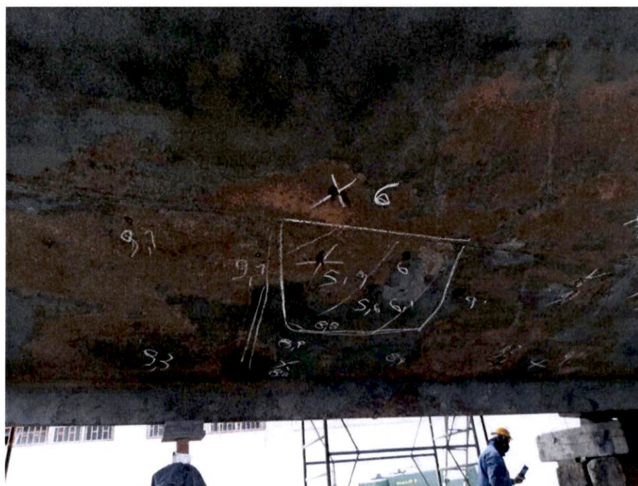
19. corrosione diffusa su lamiera primo corso di fasciame lato sinistro locale bar
