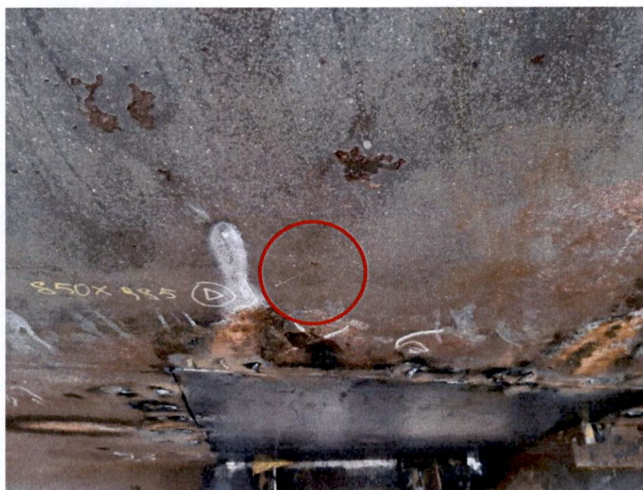
26. corrosione diffusa e passante su secondo corso di fasciame lato sinistro locale bar
