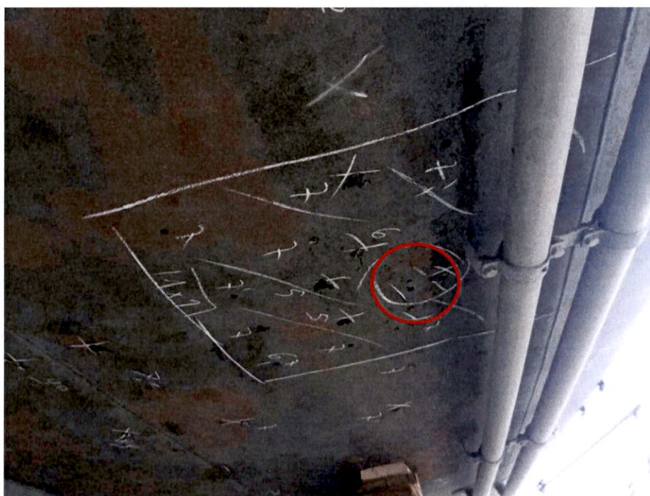
5. corrosione diffusa e passante su secondo corso di fasciame lato dritto locale casse
