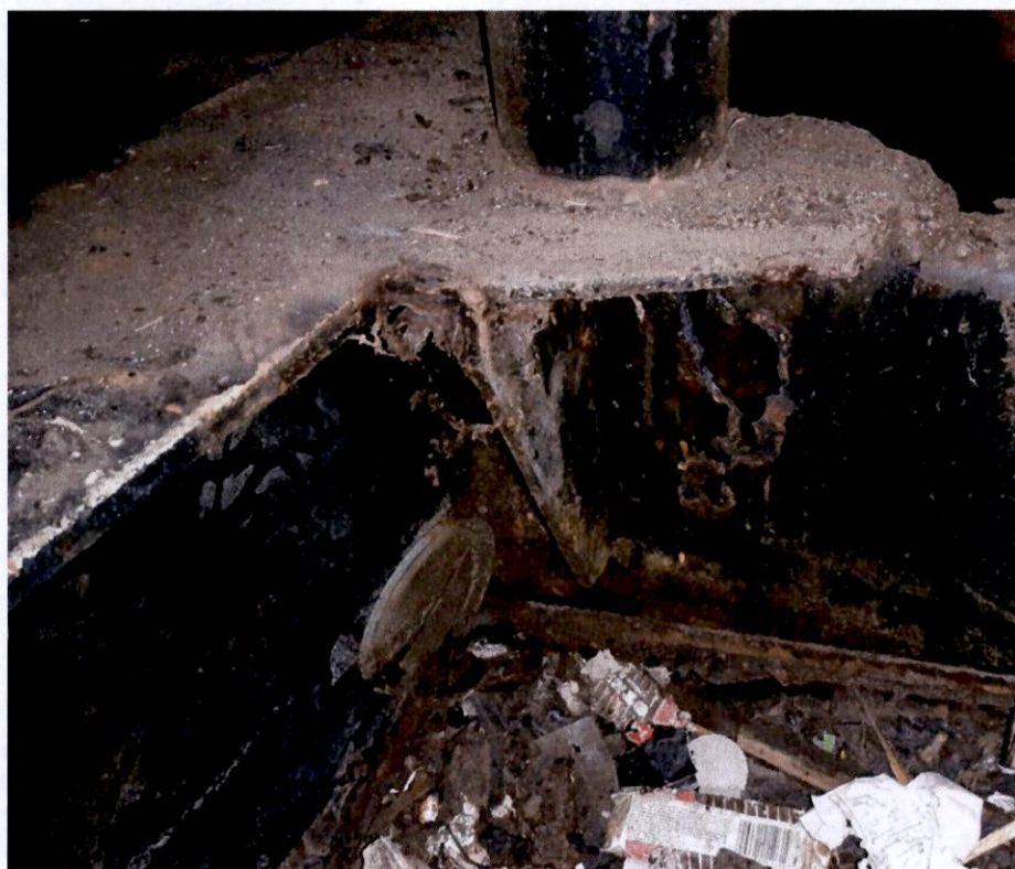
22. in evidenza corrosione diffusa e passante di madieri e paramezzale sinistro - locale bar lato sinistro
