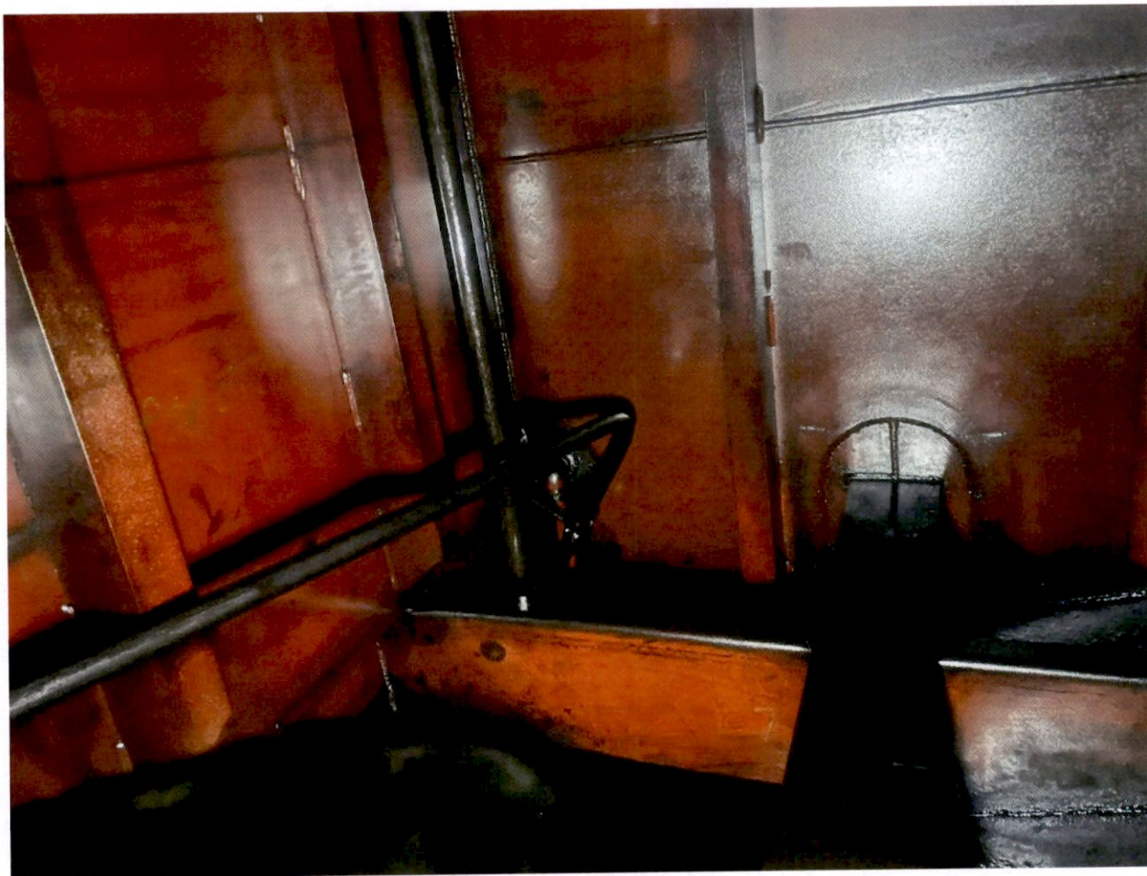
cassa principale gasolio sinistra prima della bonifica
