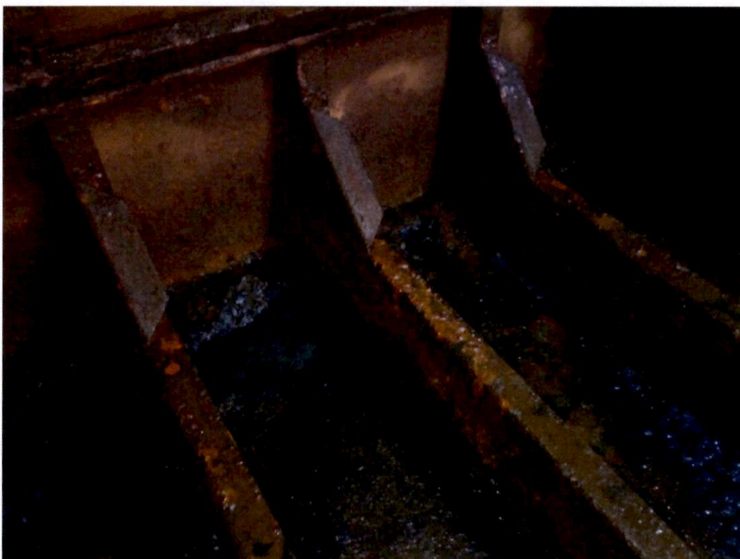
Particolare accumulo di placche di ruggine nel compartimento lato "Gambero"
