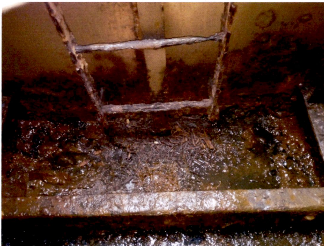
Evidente stato di corrosione della scaletta del compartimento lato "Gambero"
