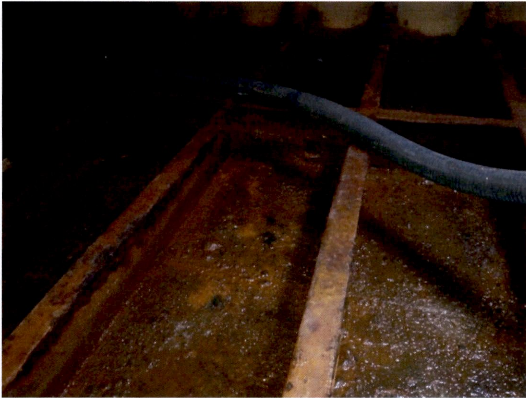
Aspirazione completa nei "frames" del compartimento centrale
