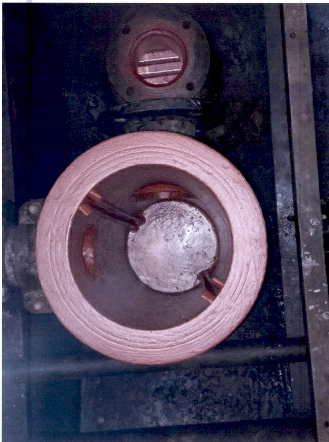
filtro presa mare dell'impianto antincendio
